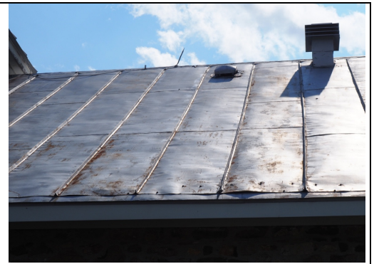
Tôle pincée de la toiture de l'ancienne petite chapelle (à l'arrière)
