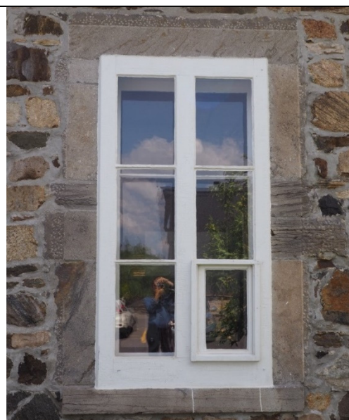
Fenêtre à battants et contre-fenêtre à carreaux en bois avec chambranle, linteau et allège en pierre de taille
