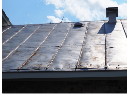
Tôle pincée de la toiture de l'ancienne petite chapelle (à l'arrière)
