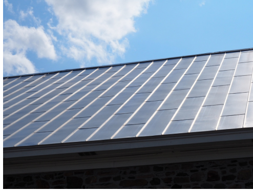
Tôle pincée de la toiture principale
